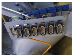
■ Высоковольтный распределительный шкаф
