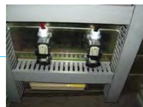
■ Подстанция коробчатого типа
